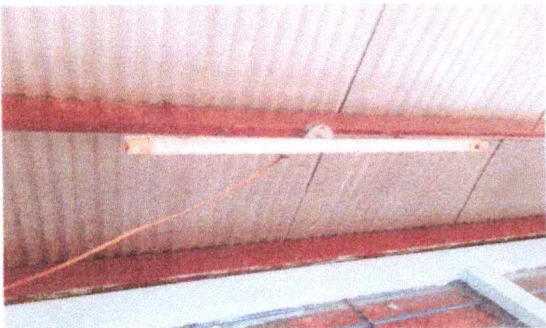
Foto 7: Estado actual del sistema eléctrico en área de corredor.
